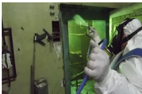
Figura 10: Sprayere decontaminantului din exteriorul camerei
